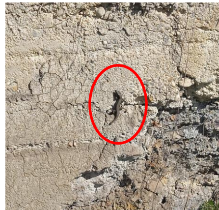
Abbruchkante im nordöstlichen Teil des Plangebietes mit Mauereidechse (Datum:14.04.2023)
